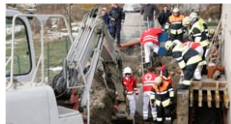
Verschütteter in Rankweil
